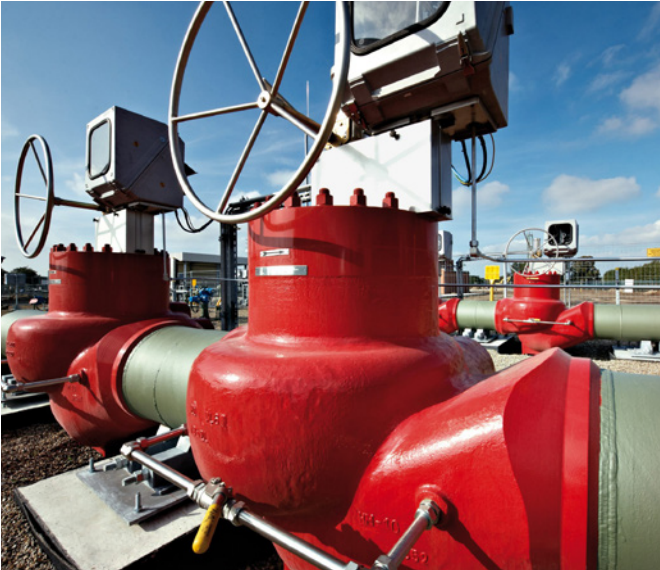
Auch Verdichterstationen der Thyssengas sollen an die krisensichere 450-MHz-Kommunikation angebunden werden
